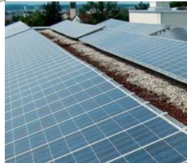
< PV-Anlage ZSG | Zürich ADEV Solarstrom AG 46 kWel | 2005
