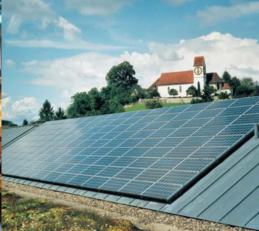
PV-Anlage Schulhaus | Magden ADEV Energiegenossenschaft 7 kWel | 1994
