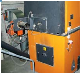
Wärmeverbund mit Holzschneitz- feuerung Haldenmatt | Embrach Oeko-Wärme AG | 360 kWth | 1999
