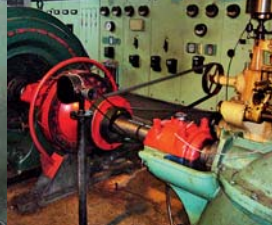
Wasserkraftwerk Hammer | Munster F ADEV Force Hydraulique SAS 400 kWel | 2011
