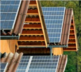
PV-Anlage Ryser | Im Buech | Oberwil ADEV Solarstrom AG | 161 kWel | 2008
