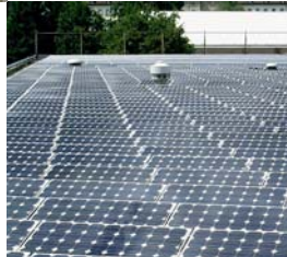
PV-Anlage Lengg | Zürich ADEV Solar KG | 75 kWel | 1998
