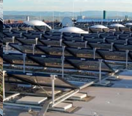
PV-Anlage Fink | Ostfildern D ADEV Solarstrom GmbH 218 kWel | 2006
