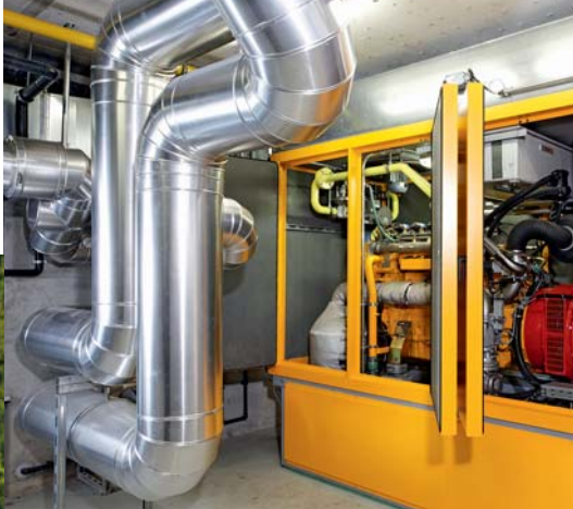
Wärmeverbund Walzwerk | Münchenstein | ADEV Energiegenossenschaft 2500 kWth | BHKW 175 kWel | 2008
