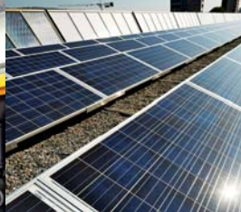
PV-Anlage MFH Minergie P | Lenzburg ADEV Solarstrom AG | 55 kWel | 2009
