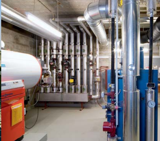
Wärmeverbund Wilder Mann Frenkendorf | Oeko-Wärme AG 285 kWth | BHKW 25 kWel | 2001
