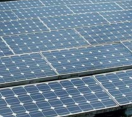
PV-Anlage Engerfeld | Rheinfelden ADEV Energiegenossenschaft 9 kWel | 1989
