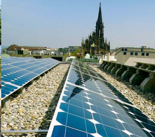
PV-Anlage Berufsfachschule | Basel ADEV Solarstrom AG 32 kWel | 2001
