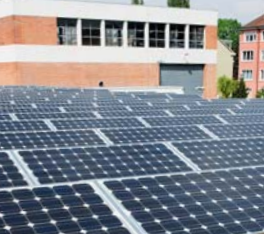
PV-Anlage Werkhofdach Nidwaldnerstrasse | Basel | ADEV Solarstrom AG 29 kWel | 2008
