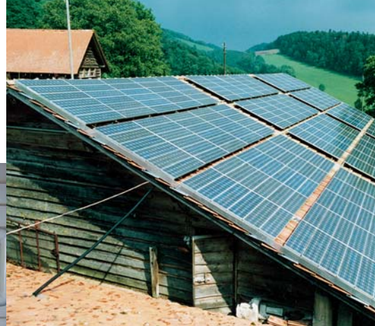
PV-Anlage Outremont | Montmelon ADEV Energiegenossenschaft | 28 kWel | 1990
