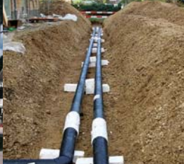
Wärmeverbund Sunnefäld | Aesch ADEV Energiegenossenschaft 380 kWth | BHKW 40 kWel | 1988/2007
