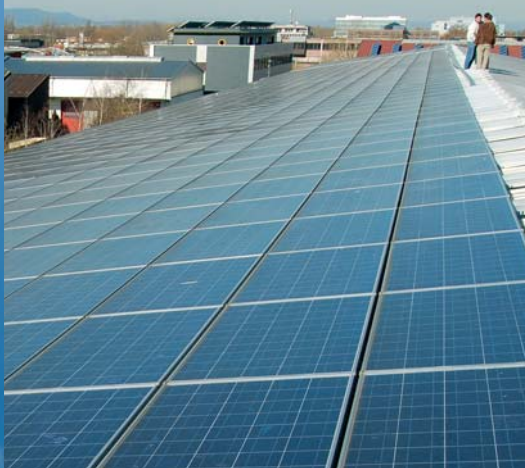
PV-Anlage Hämmerle | Konstanz D ADEV Solarstrom GmbH 118 kWel | 2004
