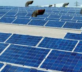
PV-Anlage VBZ Hagenholz | Zürich ADEV Solarstrom AG 170 kWel | 2001
