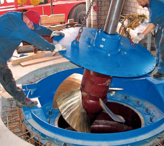
Wasserkraftwerke Emmenau KW1 + KW2 | Hasle-Rüegsau | ADEV Wasserkraftwerk AG 120 kWel und 145 kWel | 2004/2005 (2011)
