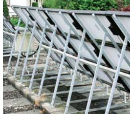
PV-Anlage Fraumatt | Liestal ADEV Energiegenossenschaft, seit 2008 ADEV Solarstrom AG 9 kWel | 1988
