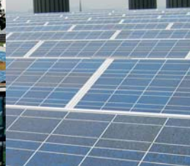
PV-Anlage Universität Irchel | Zürich ADEV Solarstrom AG 17 kWel | 2002 | Ausbau 2010 auf 71 kWel
