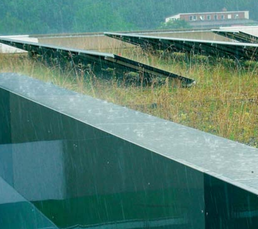
PV-Anlage Heilpädagogische Schule | Liestal | ADEV Solarstrom AG 35 kWel | 2007
