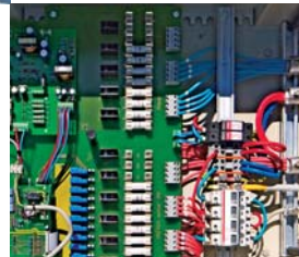
< PV-Anlage Maienbühl | Riehen ADEV Solarstrom AG 50 kWel | 2003
