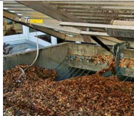
Wärmeverbund mit Holzschnittel- feuerung Schulhaus | Nuglar ADEV Energiegenossenschaft 170 kWth | 2007
