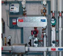
Wärmeverbund Unterwartweg | Muttenz | ADEV Energiegenossenschaft 120 kWth | BHKW 39 kWel | 1991
