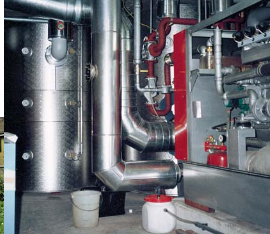
Wärmeverbund Sonnenhof | Arlesheim ADEV Energiegenossenschaft 405 kWth | BHKW 80 kWel | 1992/2009
