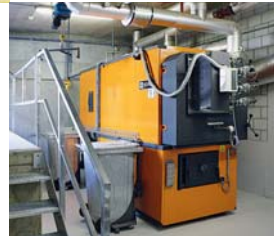
Wärmeverbund mit Holzschneitzel- feuerung Emmenau | Hasle-Rüegsau Oeko-Wärme AG 800 kWth | 2005
