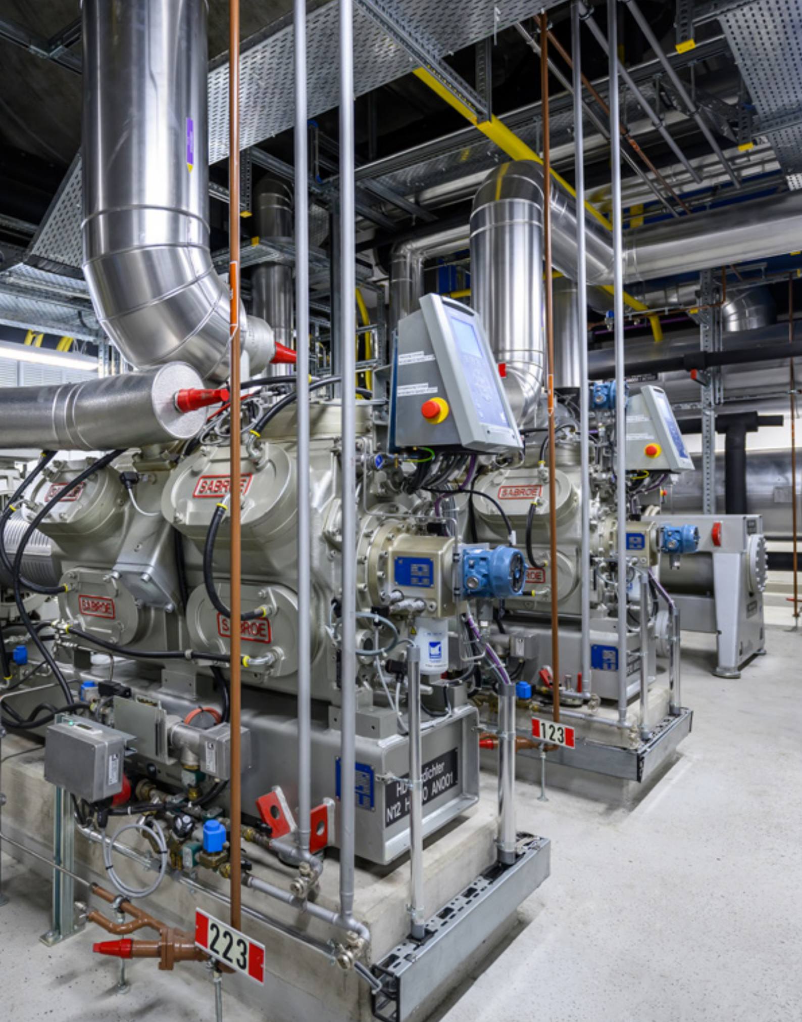
Die zwei Industriewärmepumpen (rechts im Hintergrund) bilden das Herz des Wärmeverbunds Lehenmatt Birs, den wir zusammen mit den IWB betreiben. 2023 wurden elf Mehrfamilienhäuser zusätzlich angeschlossen.
