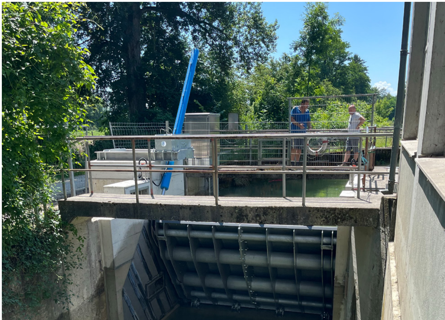
Die neue Schliessklappe mit hydraulischem Heber (blau).
