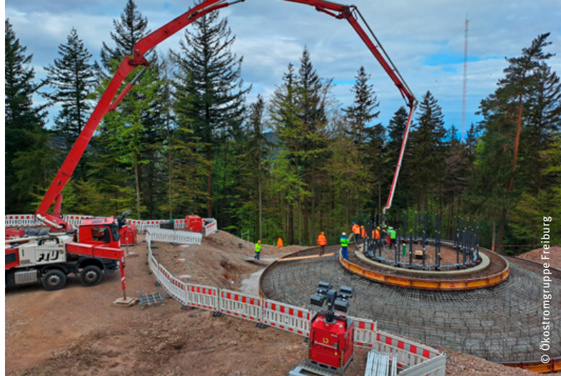
Während bei uns Einsprüche und Bürokratie die meisten Windprojekte blockieren, fließt im Schwarzwald bereits der Beton ins erste Fundament.
