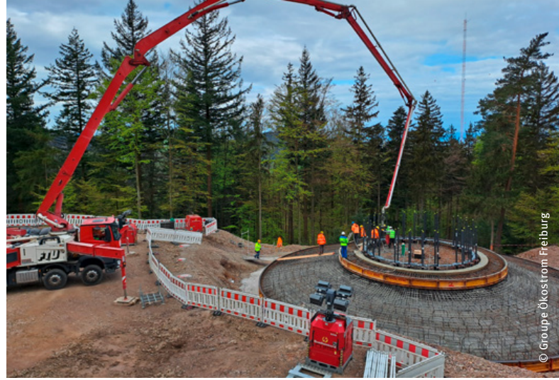
Pendant que chez nous, les recours et la bureaucratie bloquent la plupart des projets éoliens, les premières fondations ont déjà été coulées dans la Forêt-Noire.
