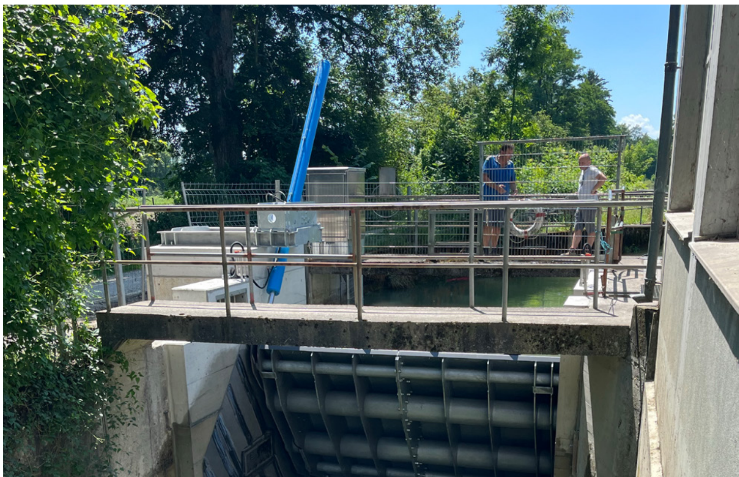
Le nouveau clapet avec vérin hydraulique (en bleu).
