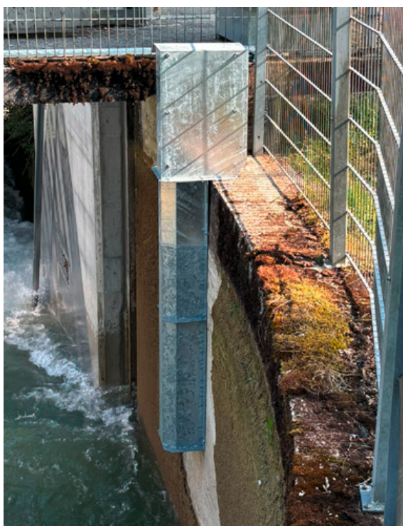
C'est dans ce boîtier en acier que se trouve le flotteur qui déclenchera le mécanisme en cas d'élévation du niveau d'eau.
