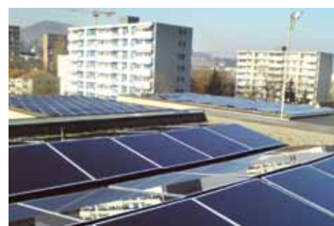
Neue PV-Anlage Schulhaus Fraumatt, Liestal
