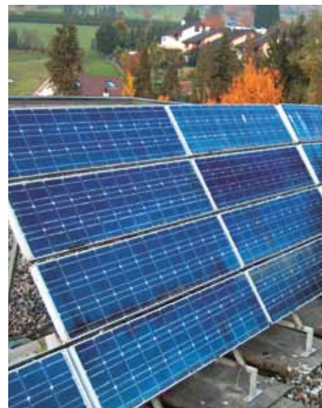
Alte PV-Anlage Schulhaus Fraumatt, Liestal
