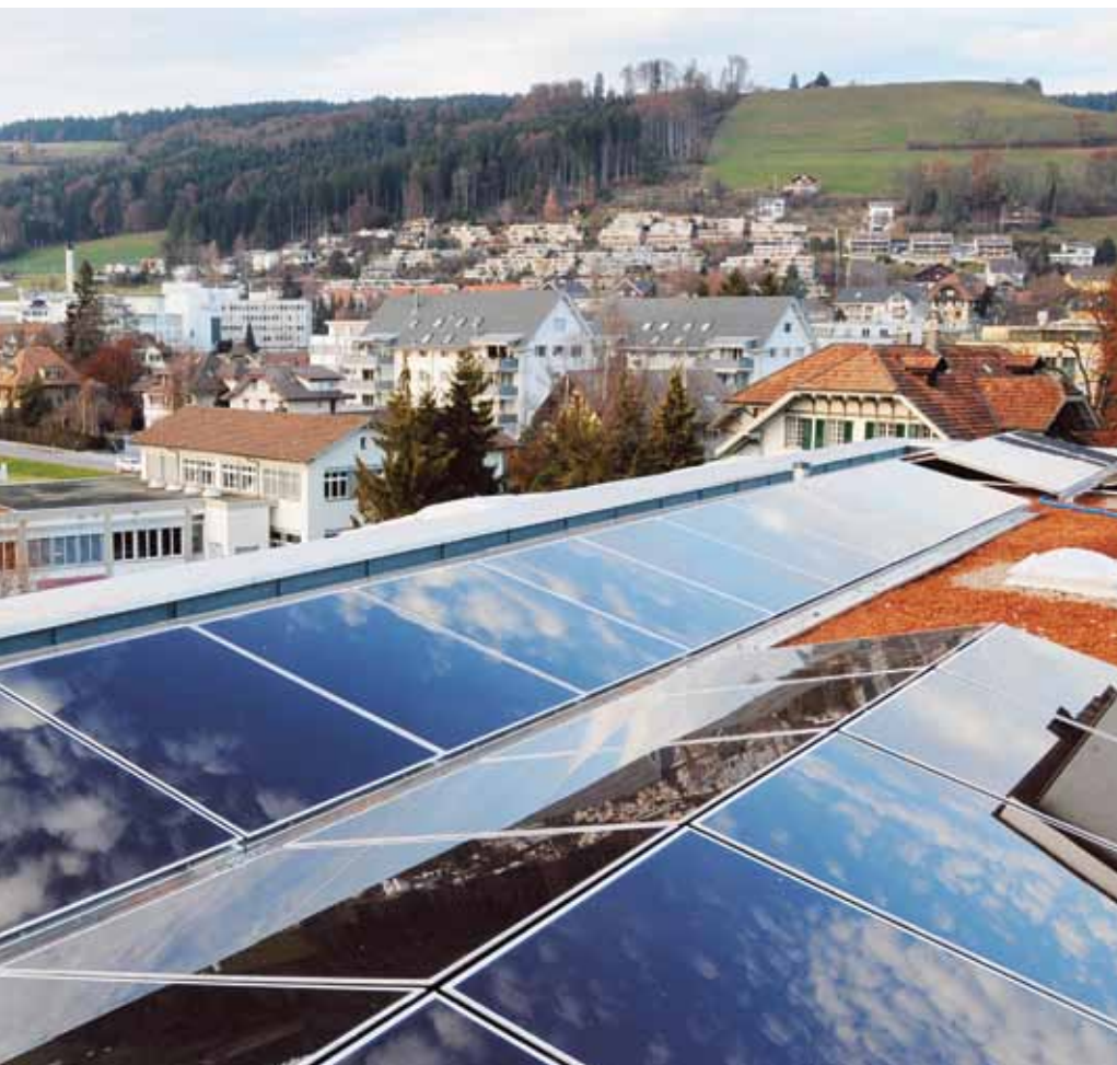
PV-Anlage Libellenweg, Konolfingen
