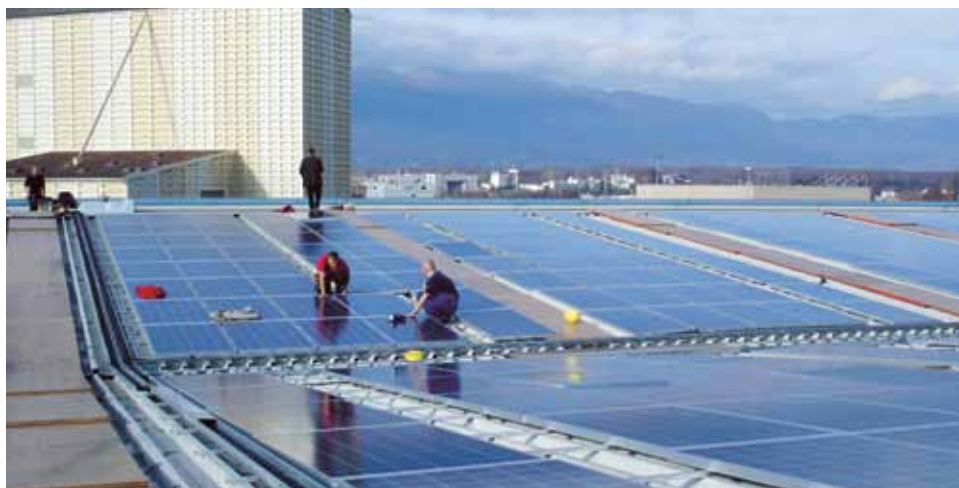
PV-Anlage Feldschlösschen, Satigny
