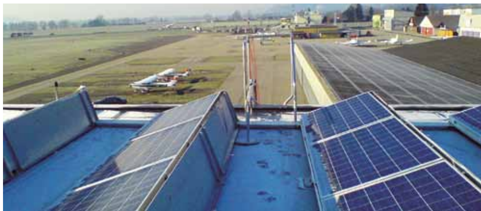
PV-Anlage Hangar Ost Flughafen, Grenchen
