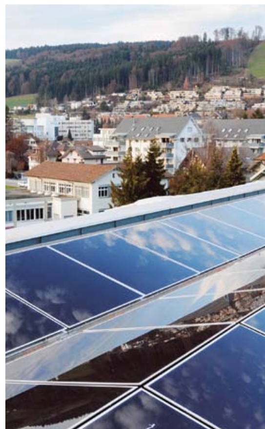
Die Ende 2011 in Betrieb genommene 37 kW Photovoltaikanlage Libellenweg in Konolfingen wurde Mitte 2013 in die KEV aufgenommen.
