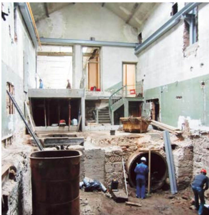
Kraftwerkzentrale inmitten der alten Fabrikhalle.
