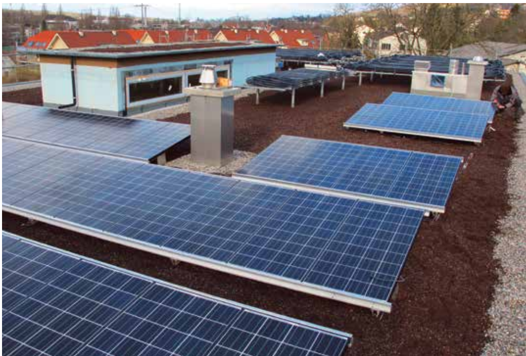
Der Solarstrom für die Wärmepumpe kommt in Dornach direkt vom Dach.
