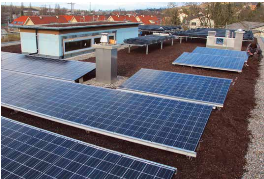
A Dornach, l'électricité qui alimente la pompe à chaleur vient directement du toit.
