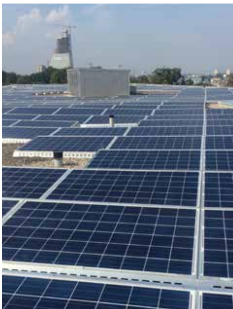
Die neue Anlage auf dem Neubau des Spitals Bethesda in Basel.
