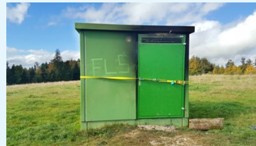
Station électrique endommagée à Saint-Brais. L'incendie serait d'origine criminelle.
