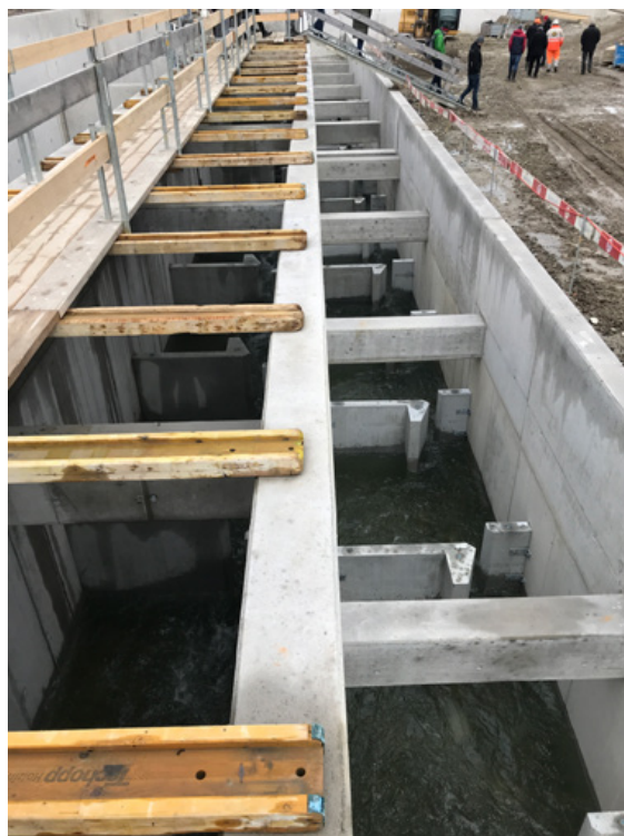
Grâce aux 31 marches du dispositif, les poissons peuvent franchir le barrage de l'Emme.
