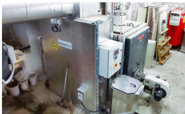
La centrale d'Emmenau, avec le nouveau filtre « Meisterfilter ».
