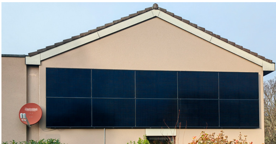
Les modules installés sur la façade sud produisent suffisamment d'électricité pour alimenter la maison individuelle.
