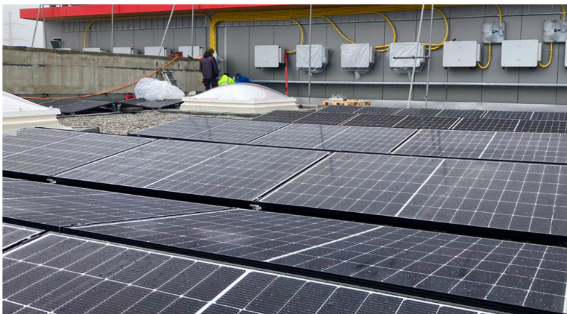
Une partie des modules solaires sont déjà montés ; contre le mur, les douze onduleurs de l'installation.
